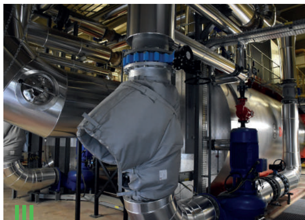
Deux nouvelles chaudières gaz (de secours) d'une puissance de 20 MW chacune.
