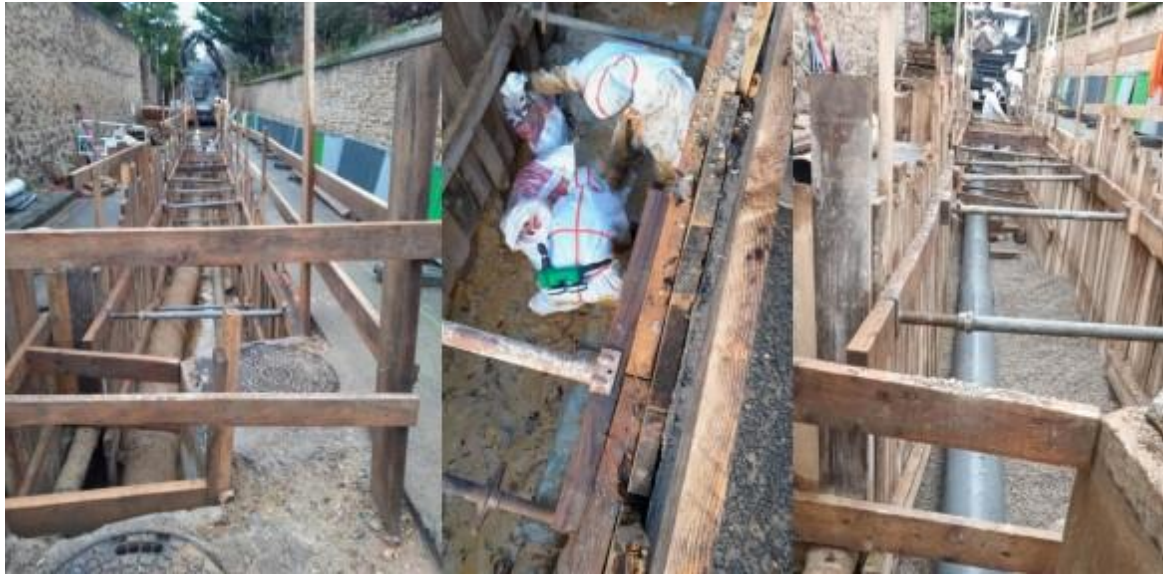
Figure 30 : Renouvellement en tranchées ouvertes des canalisations EP et EU de la rue de l'étang
