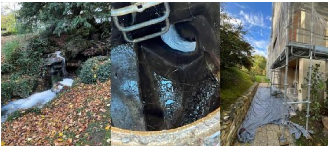
Figure 34 : Peinture dans le bassin de résidence Dauphiné
