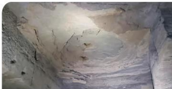
Exemple de fontis dans les galeries
