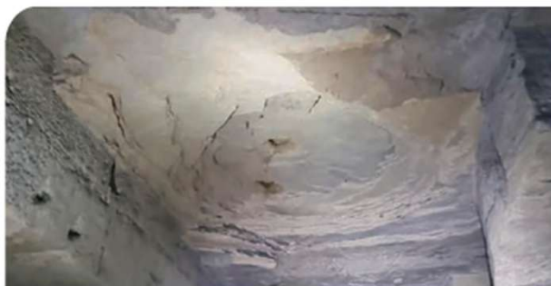
Exemple de fontis dans les galeries
